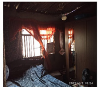
Foto: Janela emperrada e em condições precárias
