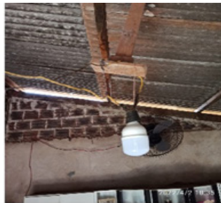
Foto: Instalação elétrica precária
