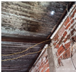
Foto: Furo nas telhas e goteira
