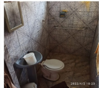
Foto: Banheiro sem acessibilidade e sem porta
